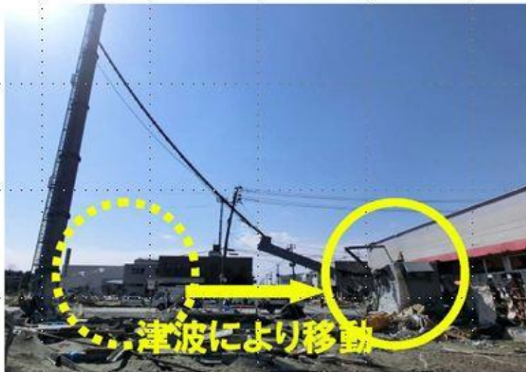
③基地局設備 (宮城県 石巻緑町設置)
